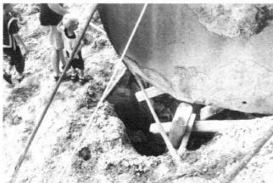
Abbildung 9 – Halde Friedrichshall (Sehnde). Notdürftig gesicherter, schlauchförmiger Hohlraum in der Rückstandshalde, der durch Salzauflösung entstanden ist und Niederschläge und Haldenwässer in den tieferen Haldenkörper und ins Grundwasser eindringen lässt.
